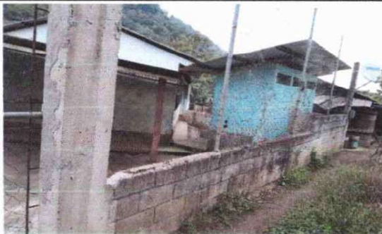
Foto 5: Muro perimetral destruido.
