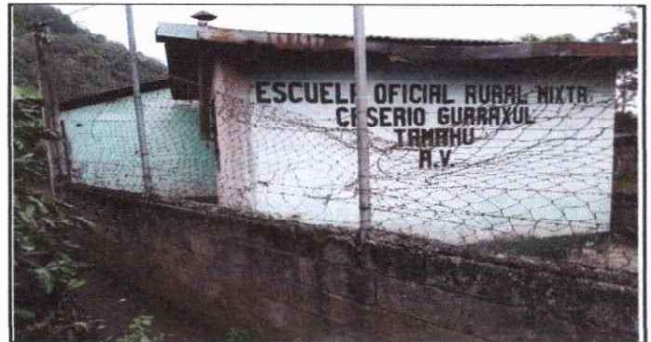
Foto 6: Muro perimetral deteriorado.
