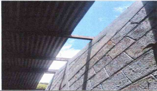
Foto1: Techos en mal estado.
