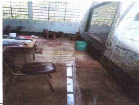
Foto 2: Goteras de techo.
