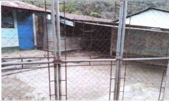
Foto 3: Portón en mal estado.
